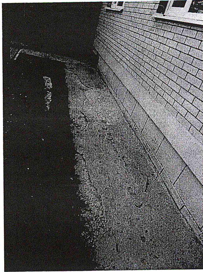
частичное разрушение отмостки
